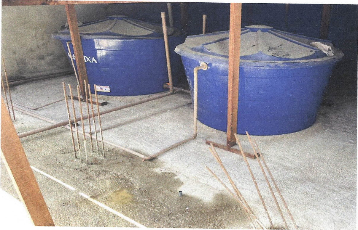
FOTO 49 - ÁGUA FRIA E BARRILETE 2º PAVIMENTO
