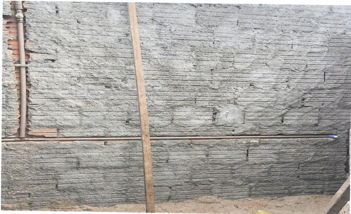
FOTO 50 - ÁGUA FRIA E BARRILETE 2º PAVIMENTO
